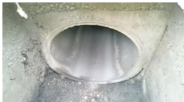
Foto 16031. Condotta acque meteoriche DN 800.
