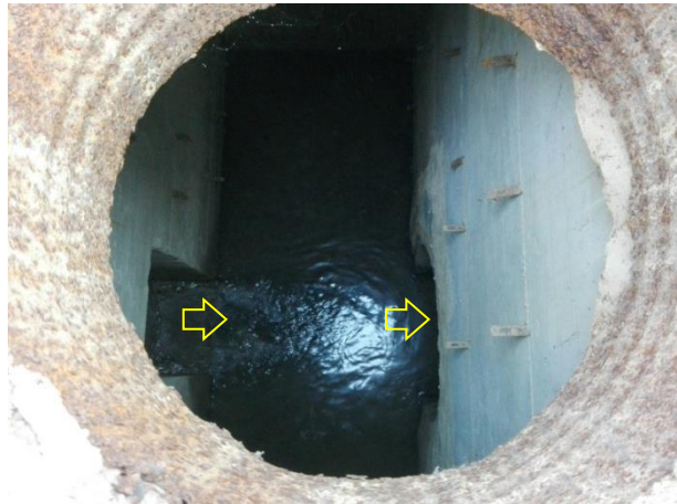
Foto 13249. Uscita dalla paratoia di regolazione e condotta di scarico verso il Sile.
