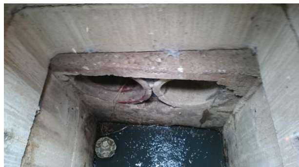
Foto 16010. Condotte DN 400 in basso (sommerse) e condotte DN 400 del troppo pieno in alto.
