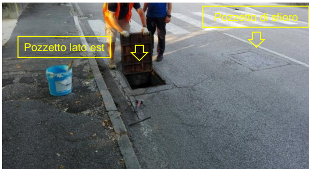
Foto 13000. Chiusini manufatto di sfioro.
