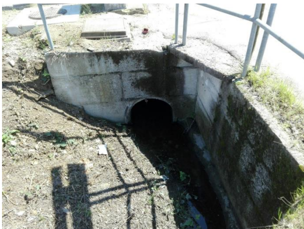
Foto 09103. Scarico della rete meteorica di via belvedere nel fosso lungo via Sant'Elena.
