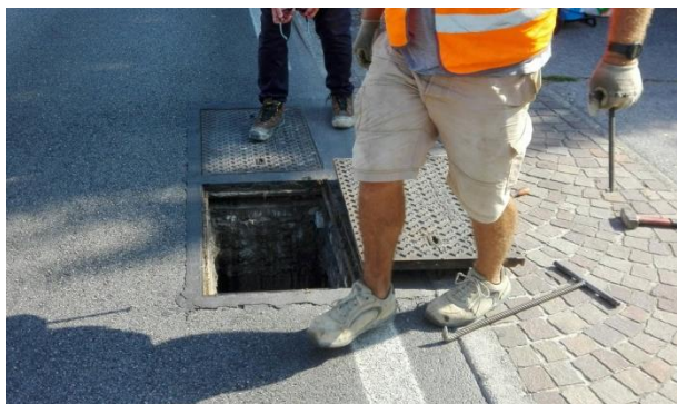
Foto 13208. Chiusini manufatto di sfioro.
