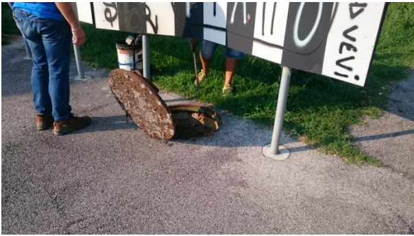
Foto 17020. Chiusino fosso tombinato in via Venturini al confine comunale.
