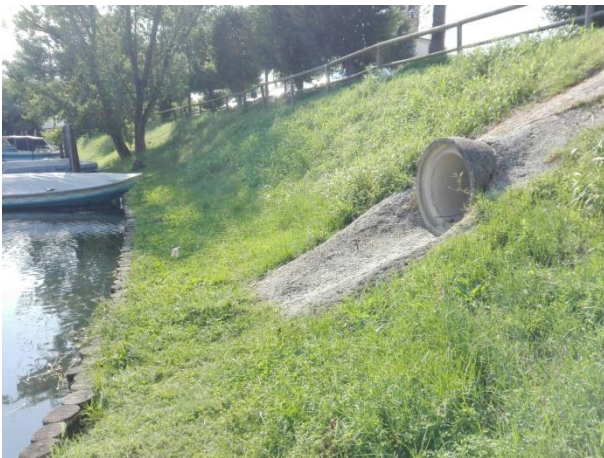
Foto 14199. Scarico nel fiume Sile.
