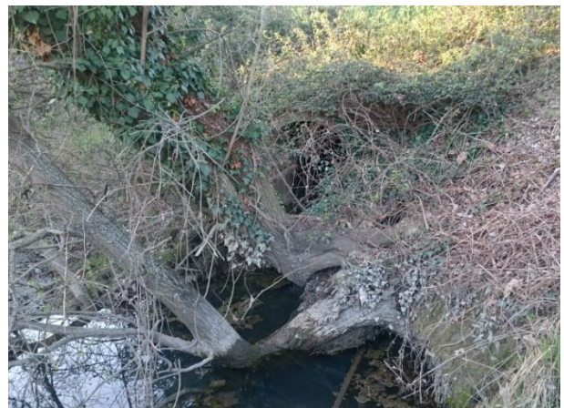
Foto 15001. Scarico della condotta nella conca.
