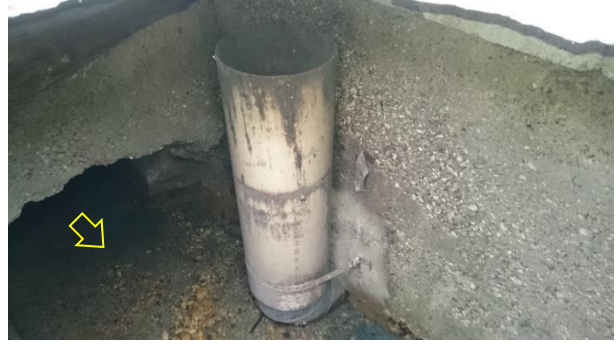
Foto 16023. Ingresso acque meteoriche via Cendon da Nord e condotta in PVC DN 300 dal troppo pieno della linea mista.
