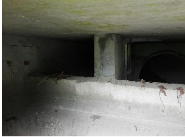
Foto 08021. Setto del manufatto regolatore.
