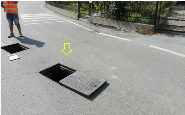
Foto 14195. Pozzetto di sfioro.
