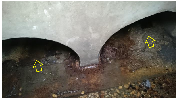
Foto 16027. Condotte di scarico ad arco affiancate.
