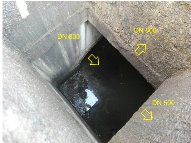
Foto 14196. Pozzetto di sfioro.
