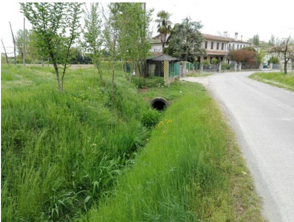
Foto 06245. Capofosso via Surexit, tombinamento a monte del nucleo residenziale presso il civico 14.
