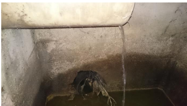
Foto 16044. Scarichi rete nel pozzetto di sfiro.
