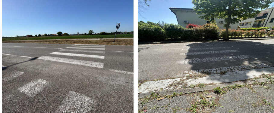
Scarsa visibilità dell'attraversamento pedonale dovuta a cattivo stato di manutenzione della segnaletica
