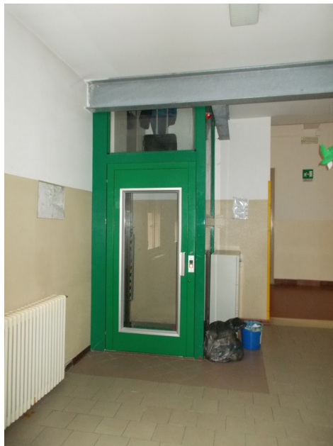
Esempio elevatore interno edificio
