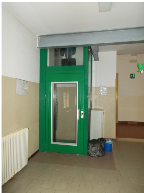
Esempio elevatore interno edificio
